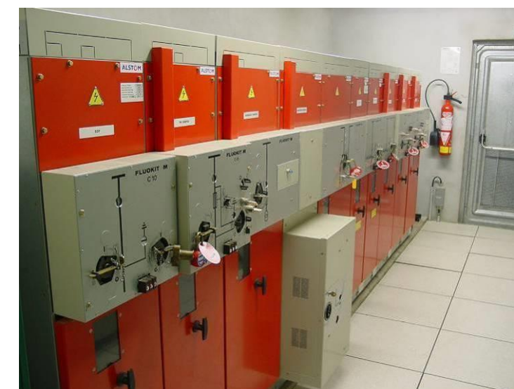
Illustration 13 : Intérieur d'un poste de livraison
