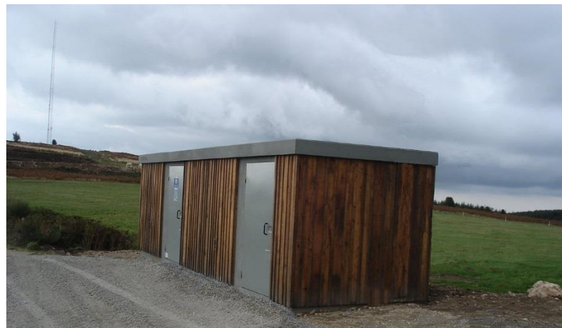
Illustration 15 : Poste de livraison du parc éolien du MARGNES (81)
